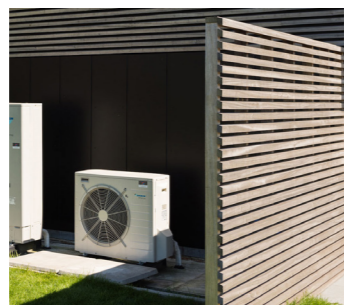
Warmtewisselaar uit het zicht door mee ontworpen afscheiding
